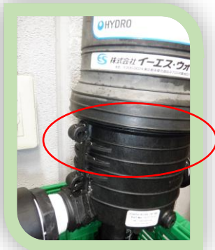
ボディから漏水
